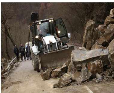
11.XII – Свлачище на пътя София-Самоков в района на Дяволския мост (снимка: БГНЕС)
