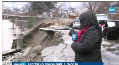
Разрушена пътна инфраструктура в Смолян
