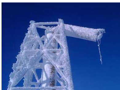
9.XI. РЛ-съоръжение на вр. Ботев след обледяване и ураганен вятър (източник: НИМХ)
